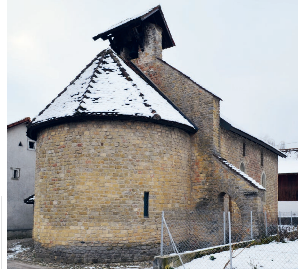
Fig. 5 : Moellons en calcaire jaune en emploi dans l'église romane de Donatyre. © Philippe Baeriswyl, SMRA
